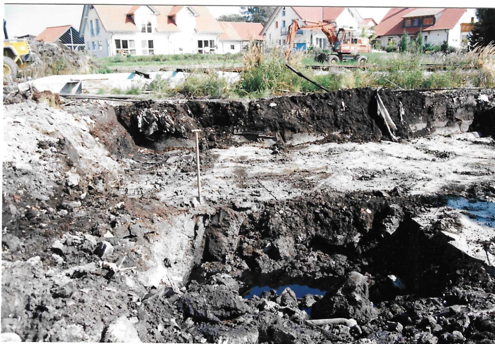
Foto 10: Das Bodenmaterial in der Umgebung der Ölschächte wurde bis auf ca. 1 Meter Tiefe abgetragen, um ausgehend von diesem Niveau durch Ausheben tieferer Schürfguben die horizontale Ausdehnung des Schadens einzugrenzen.
