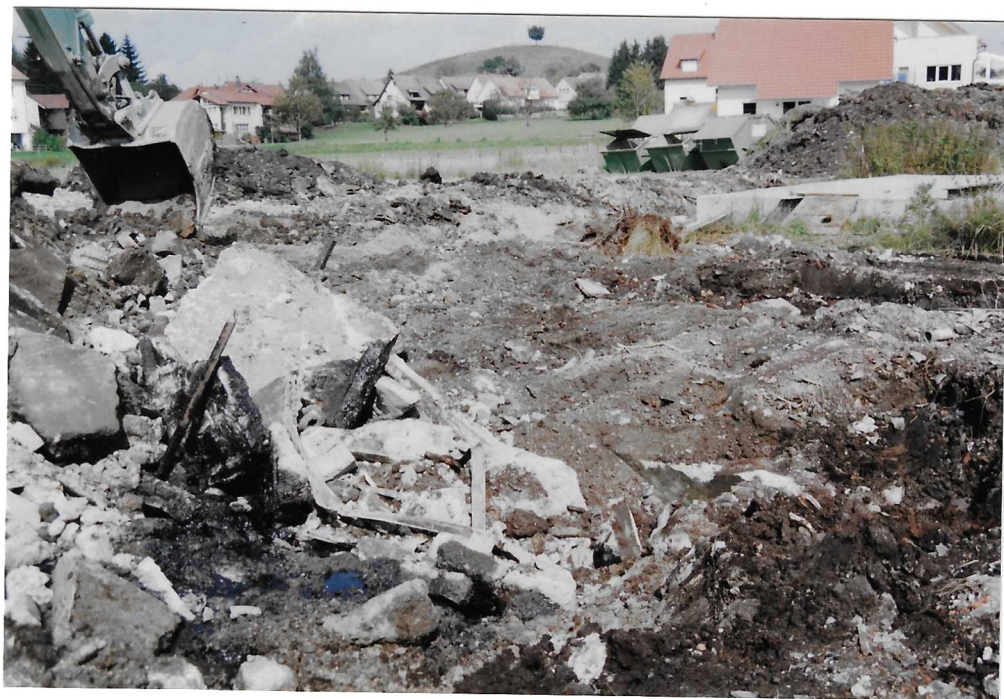
Foto 8: Beim Abbruch der Fundamente der ehemaligen Gärtnerei wurde ein mit Altöl gefüllter Schacht entdeckt (Blick Richtung Nordosten)
