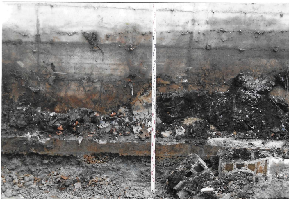
Foto 7: Im Süden wird die Baugrube durch das angrenzende Wasserbecken begrenzt – eine Restbelastung verblieb im Kiesbett unter dem Beckenboden.
