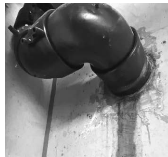
Undichtes Regenfallrohr im Putzraum der Sporthalle
